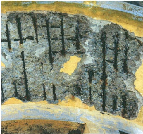
Foto 5 – Armaduras à vista na lateral exterior da cúpula
