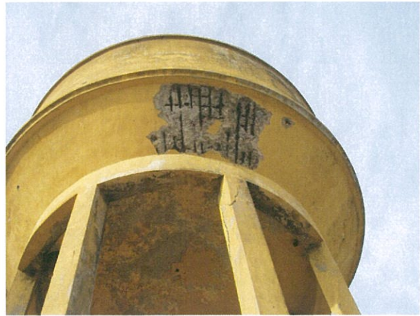
Foto 6 – Armaduras à vista na lateral exterior da cúpula
